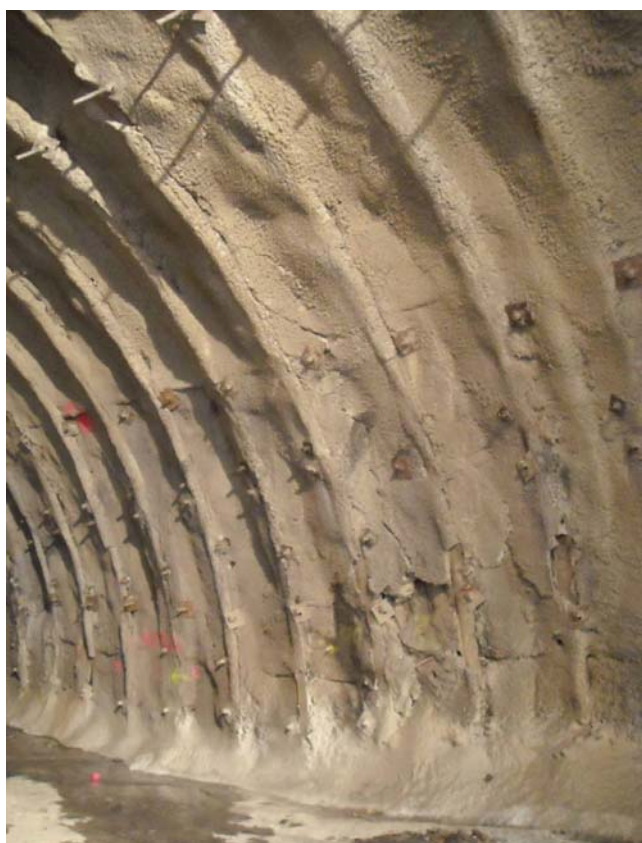
FIGURA 1. Rotura de hormigón en hastiales.
