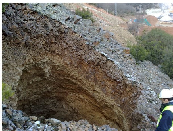
FIGURA 18. Vista de la salida al terreno del desprendimiento.
