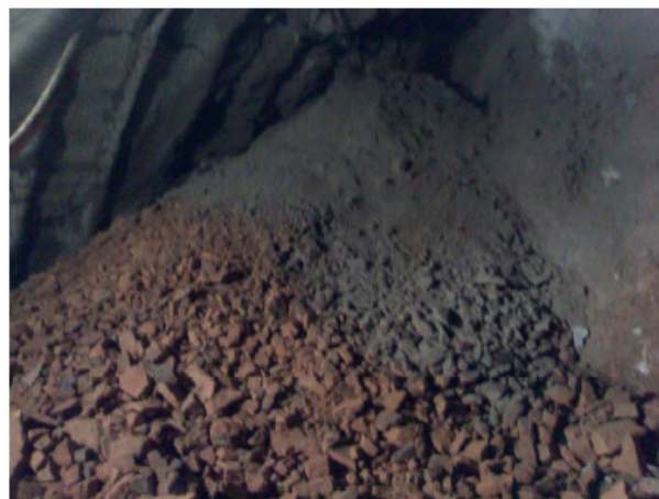
FIGURA 19. Vista del desprendimiento desde el interior.
